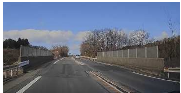
Fig. 2 のと里山海道 下り西山 PA 付近段差
